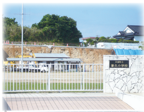
兼久小学校グラウンド西側の急傾斜地崩落箇所
