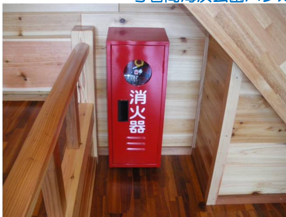
消火器（1階ベッド横）
